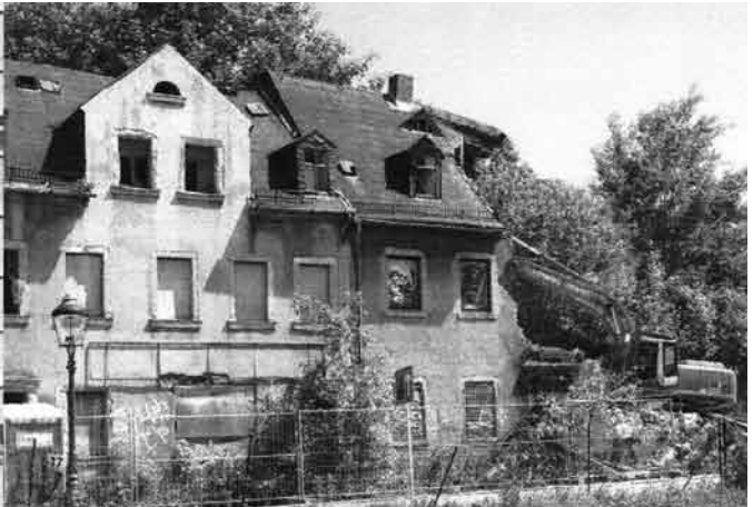
ABRISS: Diese zwei uralten Häuser an der Hauboldstraße wurden jetzt abgerissen und das Gelände bis vor an die Müllerstraße bereinigt.
